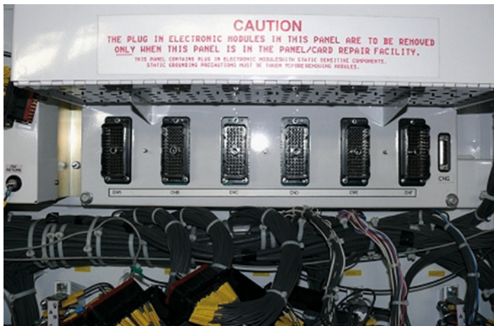
Fot. 7. Szafa elektryczna i panele elektroniczne
